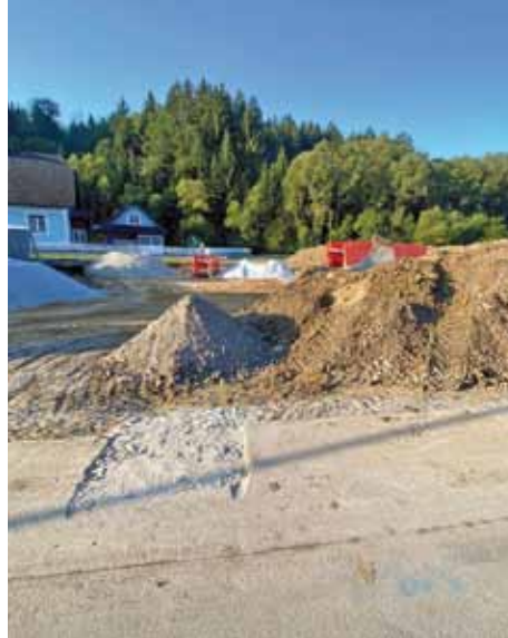
Regenwasserkanal und Rückhaltebecken
