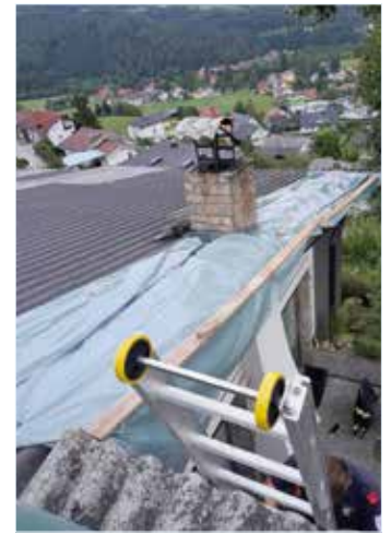
Hausdächer wurden zerstört
