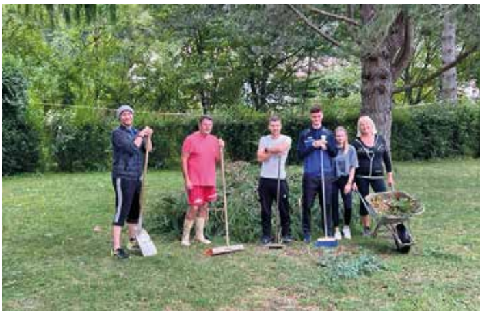
Im Schlossbad: Aufräumarbeiten nach dem Sturm
